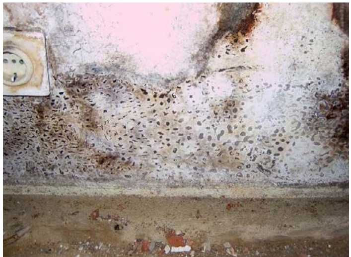
Abb. 2 Mit Schimmelpilz befallene Leichtbauwand aus Gipskarton nach einem Leitungswasserschaden
